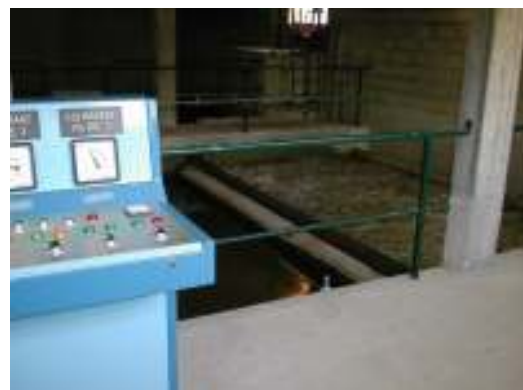
Station traitement à Casteil (poste contrôle)
